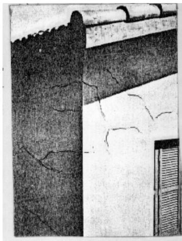
Figura 9.8 - Fissura do revestimento externo por expansão da argamassa de assentamento
